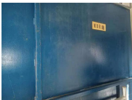
污水处理站 MBR 池
