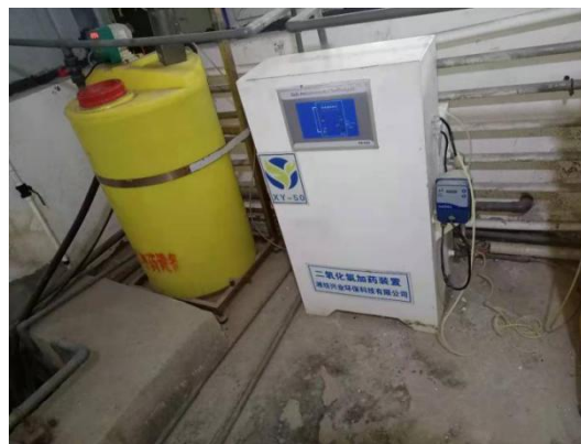
污水处理站废水消毒池
