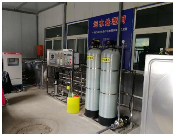
污水处理站反渗透设施
