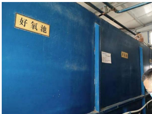
污水处理站好氧池
