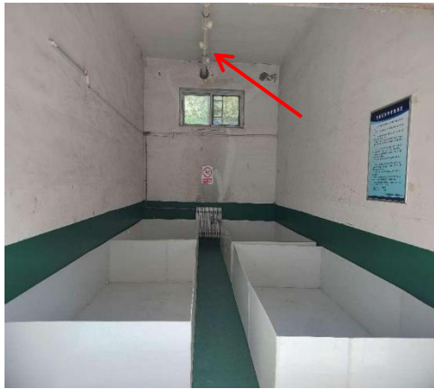
废气收集管道
